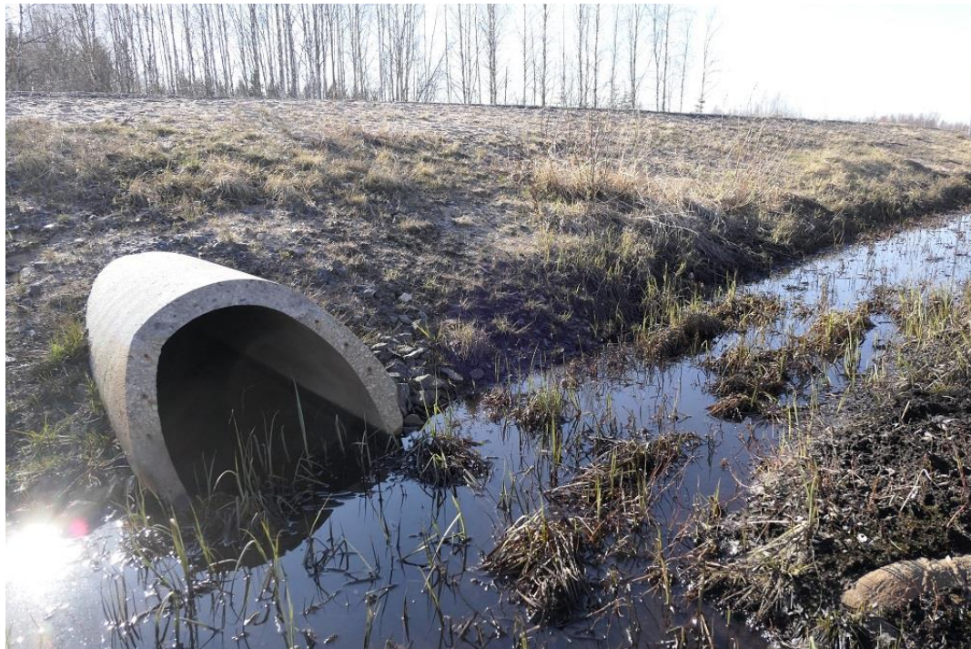
Kuva 12. Viitasammakot pystyvät todennäköisesti rumpua pitkin liikkumaan kohteen 3 ja 4 välissä.
